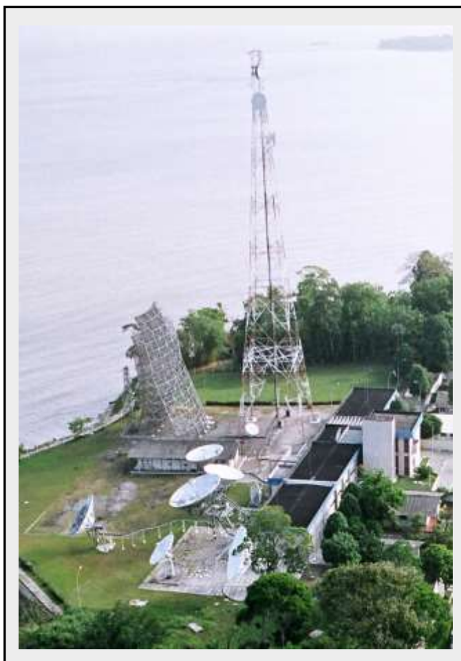
Foto 14: Torre de transmissão da rede de telefonia. Foto: SEGEP, 2006.
