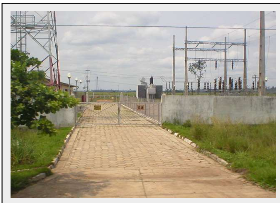
FOTO 08: Aspecto da Sub-estação da Rede Celpa. Foto: Costa, 2006.
